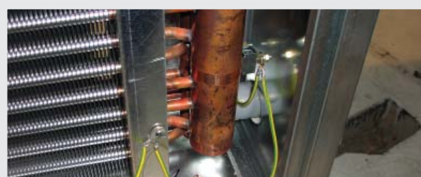
Заземление пластин байпасного клапана пластинчатого рекуператора
