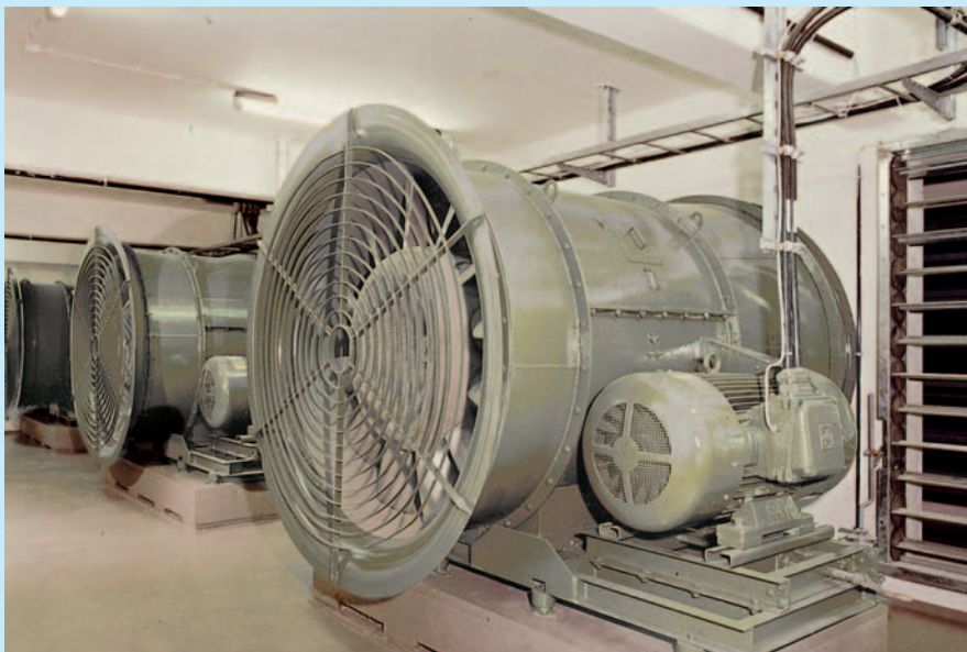
Осевые вентиляторы AXN 12/56/1600 R2 централи распространения приточного воздуха административного здания в Гамбурге, Германия
