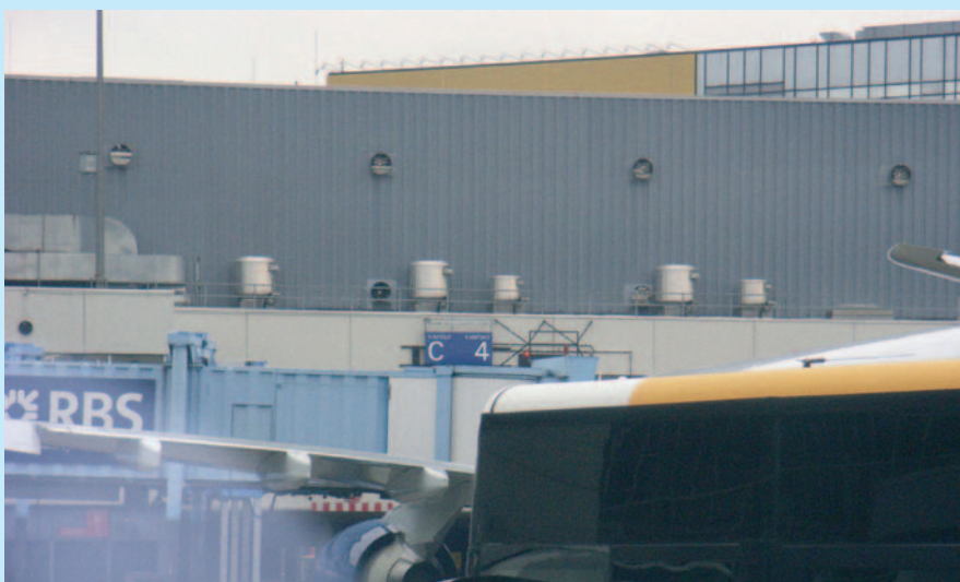
Крышные вентиляторы дымоудаления BVD 630 - F 600 (Аэропорт Франкфурт-на-Майне, Германия)
