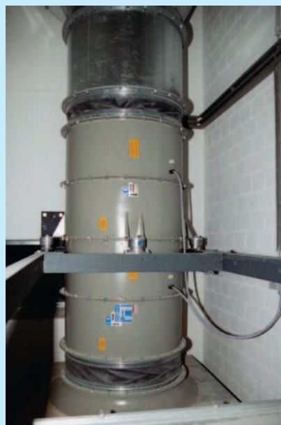
Вертикально смонтированный гаражный осевой вентилятор тип ZAXN 12/56/630 (крытая автостоянка в аэропорту Штутгарта, Германия)
