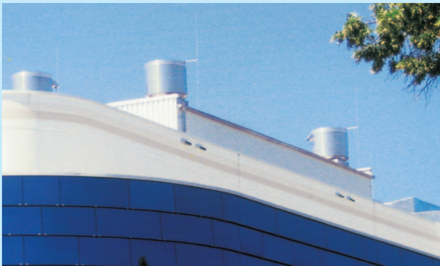
Крышные вентиляторы дымоудаления тип BVD 710 XL - F 400 (Салон мебели Зегмюллер в Аугсбурге, Германия)
