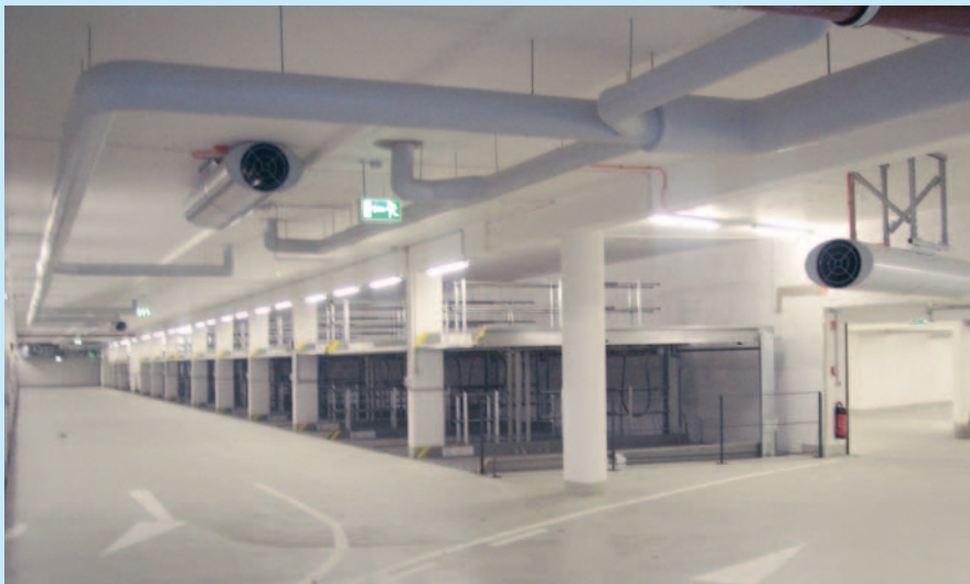
Вентиляторы дымоудаления BVGAXN400 - F 300 в системе проточной вентиляции (подземный гараж Эшервег в Ольденбурге, Германия)
