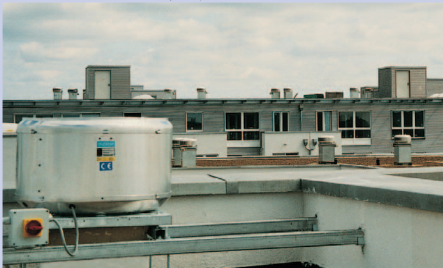
Крышные вентиляторы серий DRV и DRH для общеобменной вентиляции жилых помещений (Вассерштадт в Берлине-Шпандау, Германия)
