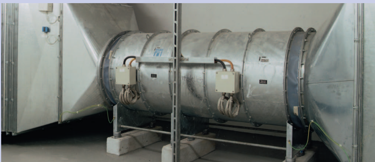
Гаражный осевой вентилятор ZAXN 12/56/1120 в оцинкованном исполнении (подземный гараж в новой части Дрездена, Германия)
