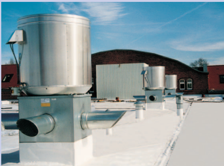
Крышные вентиляторы дымоудаления BVD 630/30-6 - F 600 с воздуховодами для всасывания наружного воздуха (Земельный архив Берлина, Германия)
