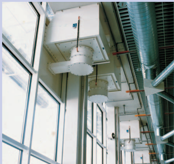
Настенные вентиляторы дымоудаления серии BVW-R (операционный зал для работы с грузом, аэропорт Мюнхена, Германия)
