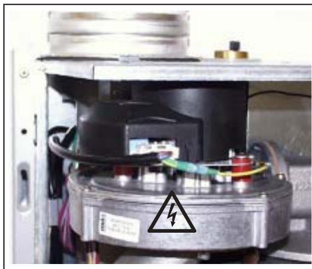
Рис.: Штекер вентилятора: опасность от электрического напряжения
