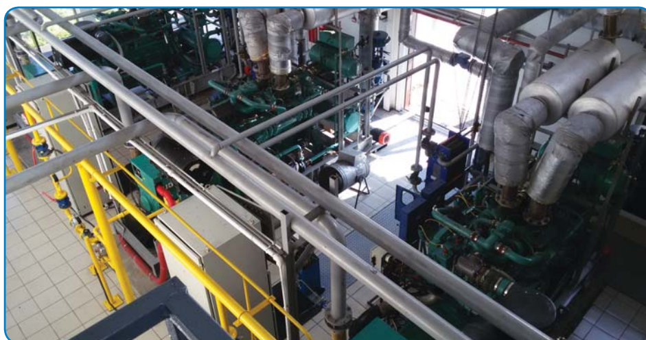
Общий вид станции внутри
