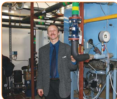
В котельной микрорайона Куркино
