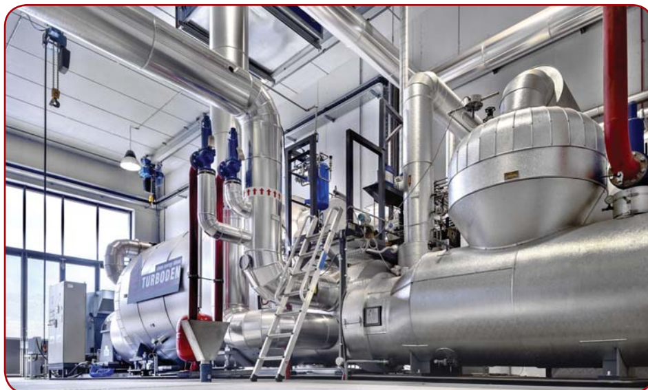
Комплекс получения электроэнергии на биомассе 800 кВт
