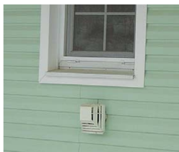
Рис. 2. Оголовок коаксиального газохода на фасаде здания
