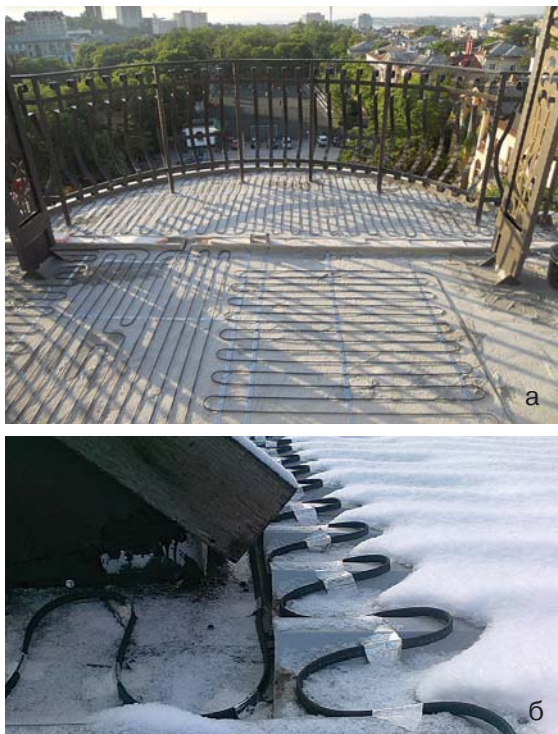
Рис. 4. Теплый пол на балконе (а); обогрев крыши (б)
