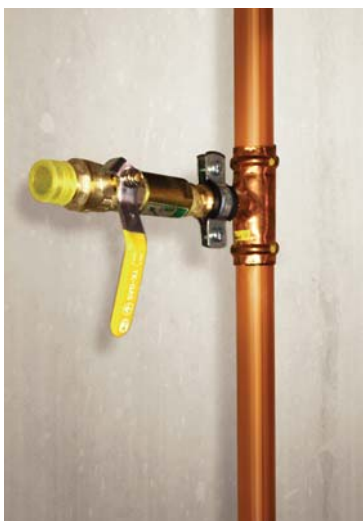
Рис. 3. Внутренний газопровод на основе медной трубы
