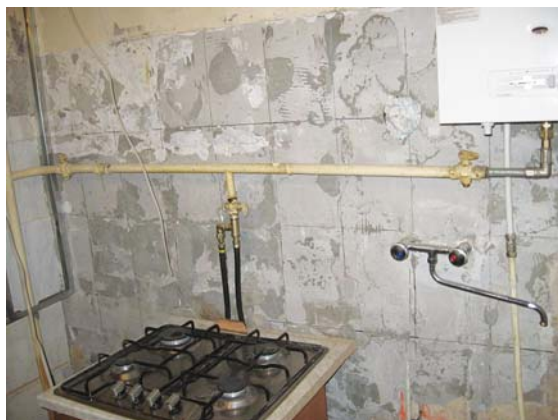
Рис. 1. Внутренний газопровод, проложенный открытым способом
