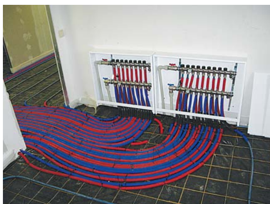
Рис. 1. Коллекторы в системе теплого пола
