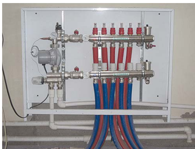
Рис. 4. Смесительный узел и регулировочные коллекторы системы теплого пола, установленные в одном шкафу
