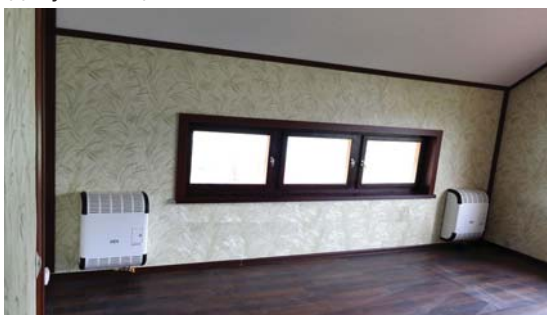
Рис. 3. Газовые конвекторы, установленные в мансарде
