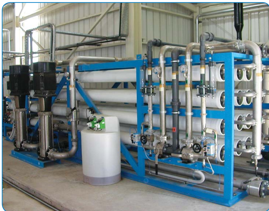
Рис. 7. Узел дозирования реагента на УОО
