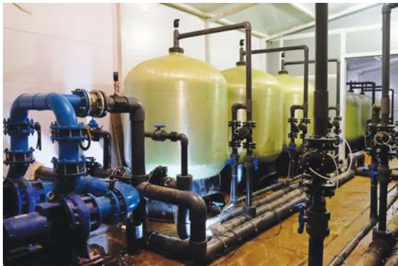
Рис. 6. Осадочные фильтры под управлением контроллера «Суперматик» SM-8. Станция водоподготовки номинальной производительностью 150 м³/ч. Город Воскресенск, МО
