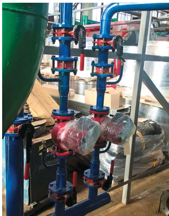
Циркуляционные насосы Grundfos серии UPS
